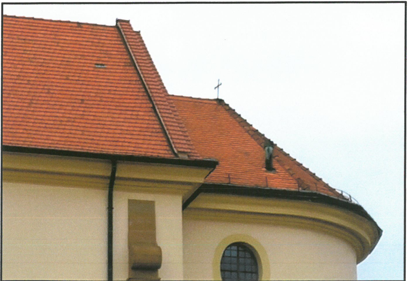
Widok kościoła od strony południowej - widoczna dachówka zakładkowa na dachu nawy i dachówka karpiówka nad prezbiterium;
